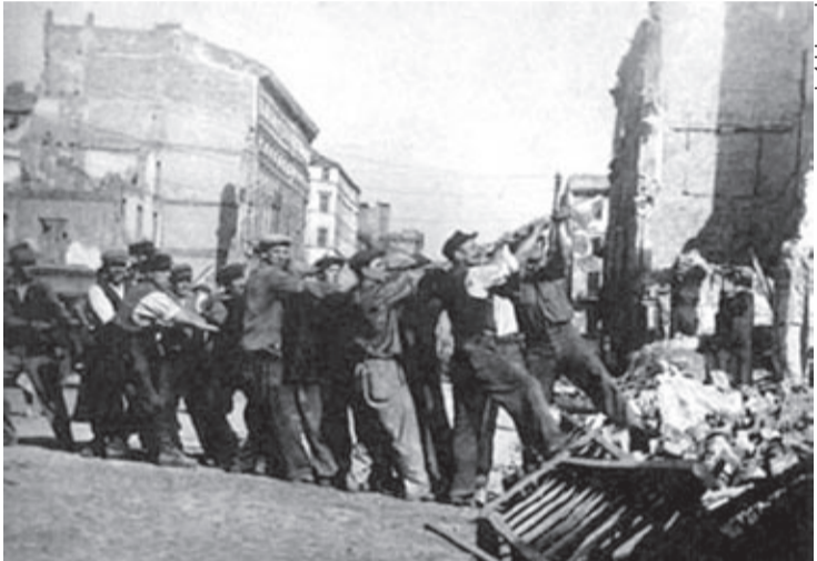
Rozbiórkę domu zaczynało od powalenia na ziemie wysokich ścian. Przez otwory okienne gdzieś wysoko wiązano mocną linę, którą potem szarpała grupa robotników, lub kołowrót. Ściana waliła się z hałasem...
