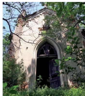
KUTYSZCZE. ZDEWASTOWANA ŁACIŃSKA KAPLICA, STAN 2012
